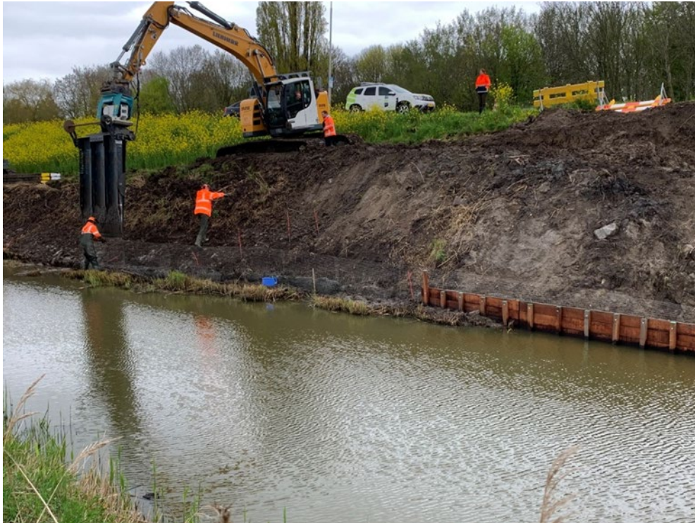
Afbeelding 4.2: het drukken van gaas in een waterkering - met daarboven een weg - waarin bevers holen hadden gegraven in Numansdorp.
