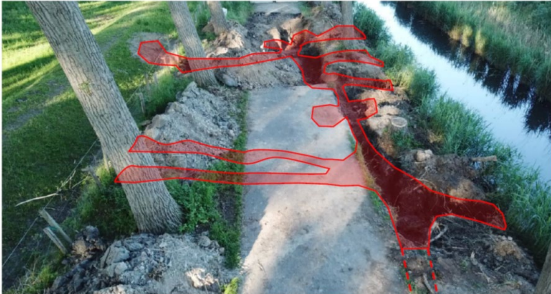
Afbeelding 4.3: Contouren van beverholen (in rood) onder ongeveer 15 strekkende meter van de Van Pallandtweg bij Middelharnis, begin juni 2021.
